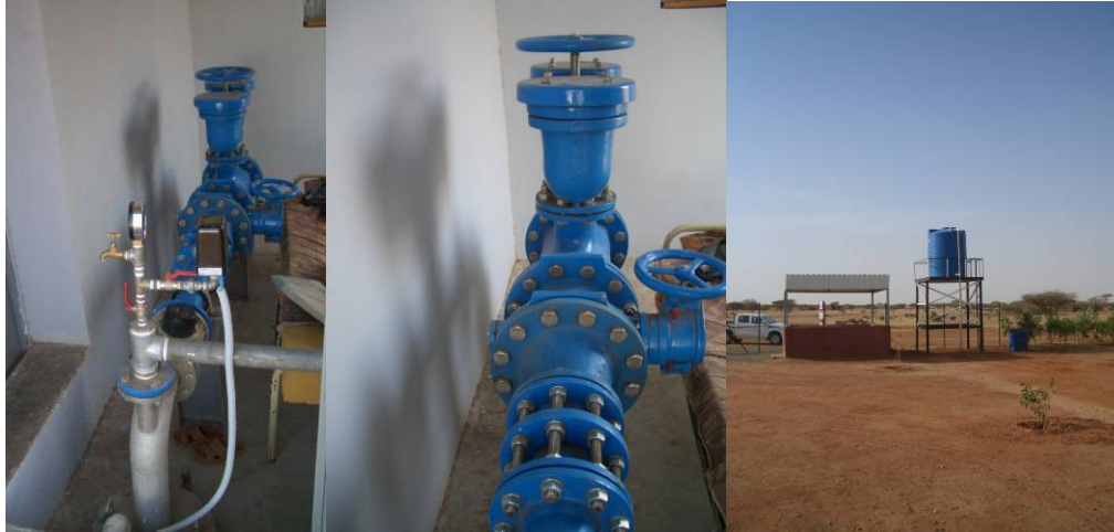
Brunnenkopf (l, m), Brunnenanlage (r)
